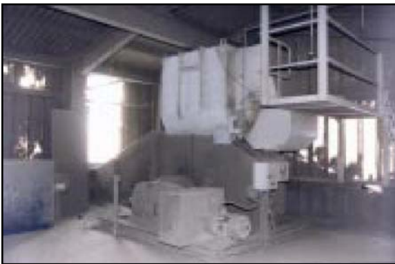
Innerhalb der Zementherstellungsanlage entlüftet die Dalamatic Entstaubungsanlage das Gehäuse und den Zemententladungspunkt.
